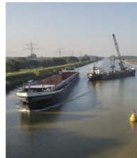
Woensdag wordt er langs het Julianakanaal gewerkt aan marifoonmasten. FOTO JOHANNES TIMMERMANS
